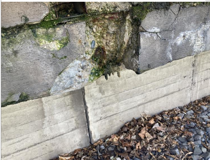
Abbildung 4: U-Bahnhof Studentenstadt Bahnsteigkonstruktion – beschädigter Kragarm
