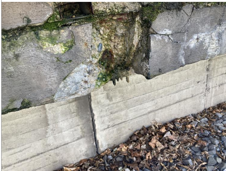
Abbildung 4: U-Bahnhof Studentenstadt Bahnsteigkonstruktion – beschädigter Kragarm
