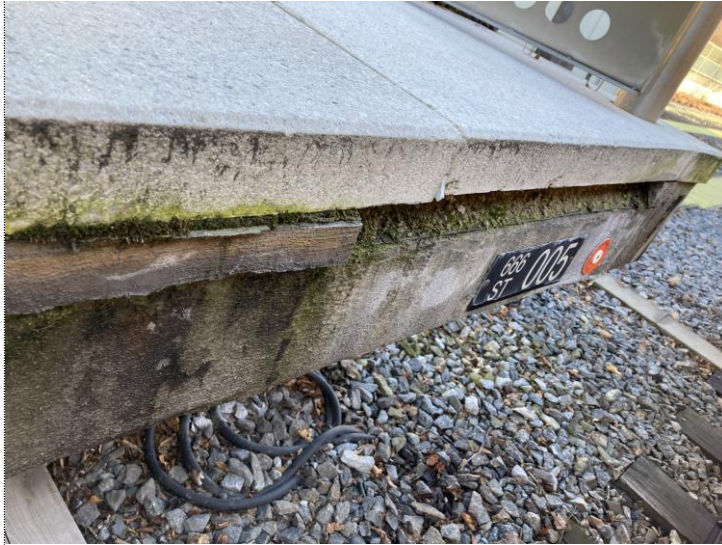
Abbildung 3: U-Bahnhof Studentenstadt Bahnsteigkonstruktion – hohl liegende Platte
