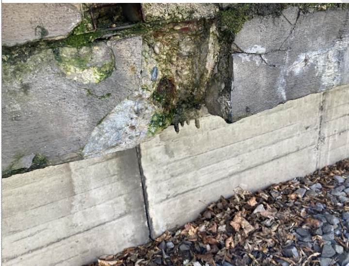
Abbildung 4: U-Bahnhof Studentenstadt Bahnsteigkonstruktion – beschädigter Kragarm
