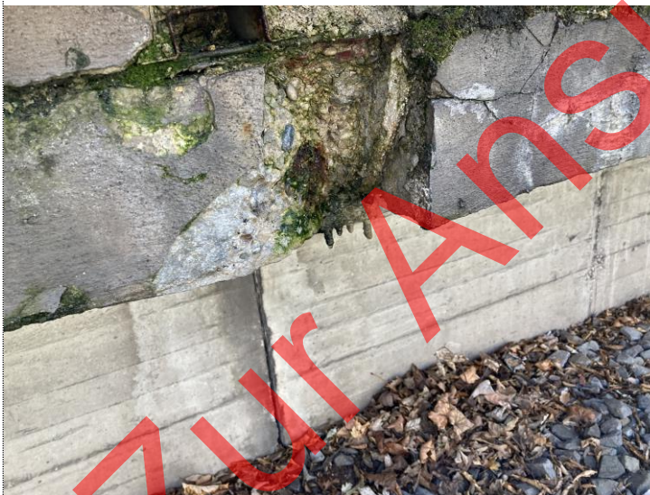
Abbildung 4: U-Bahnhof Studentenstadt Bahnsteigkonstruktion – beschädigter Kragarm
