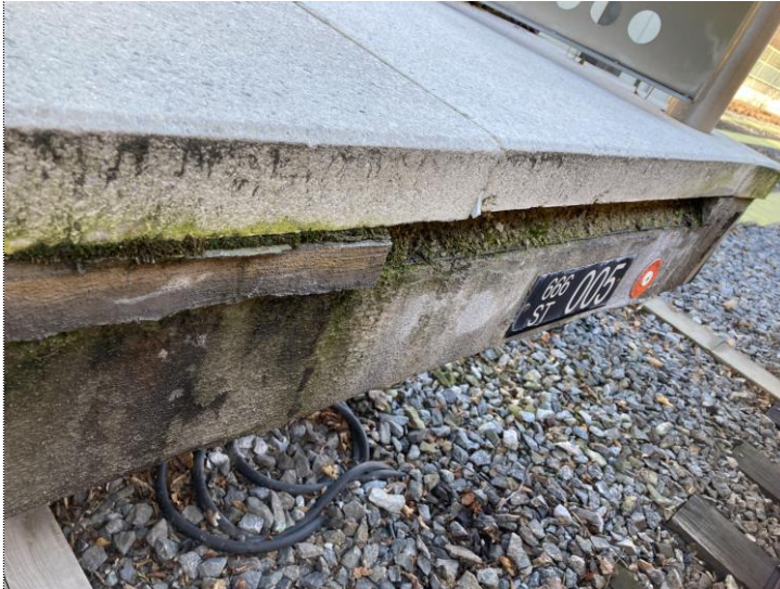
Abbildung 3: U-Bahnhof Studentenstadt Bahnsteigkonstruktion – hohl liegende Platte
