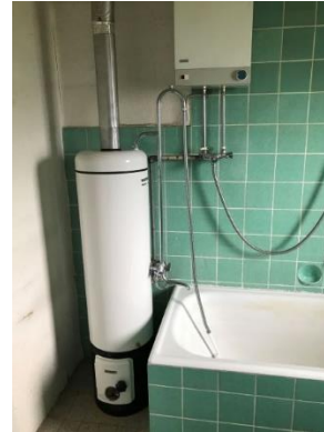
Boiler Badezimmer Wohnung OG
