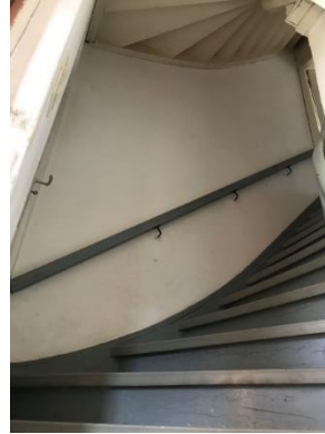
Treppenaufgang – Sturzgefahr bei Besichtigung –
