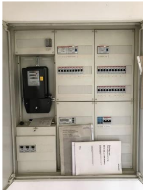
Sicherungskasten Wohnung EG
